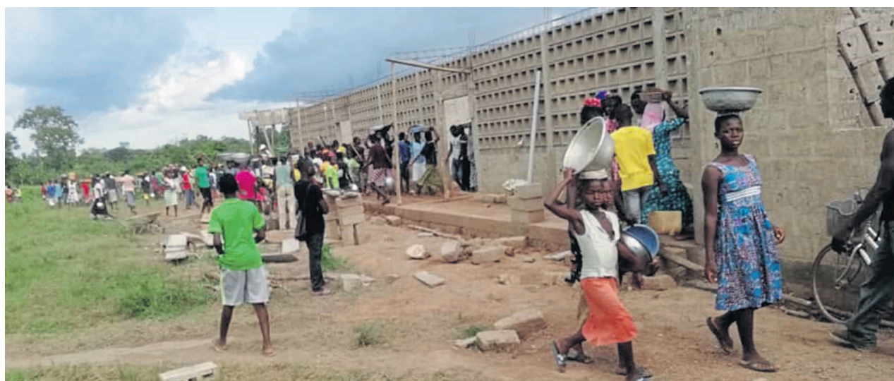
Schüler und Eltern sind so dankbar für die Schule, dass sie bei Basisarbeiten selber mithelfen. Inzwischen steht der Rohbau.
